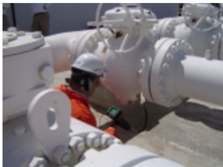
Fig. 1.3 Lectura de confirmación de fuga en una de las válvulas seleccionadas para la inspección.
