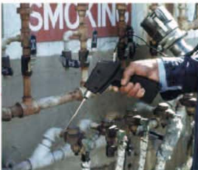
Inspección de trampas de vapor
