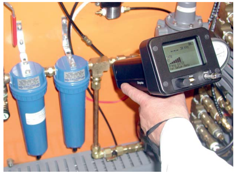
Eine erfolgreiche Druckluftleckageprüfung hängt davon ab, ob das richtige Ultraschallmessgerät für die Anforderungen der Prüfung verwendet wird, das Personal entsprechend geschult ist und eine detaillierte Planung der Inspektion durch einen ersten Rundgang gemacht wurde. Die Dokumentation der Lecks und der damit verbundenen Leckagekosten und die Reparatur sind die nächsten Schritte. Bilder: UE Systems
