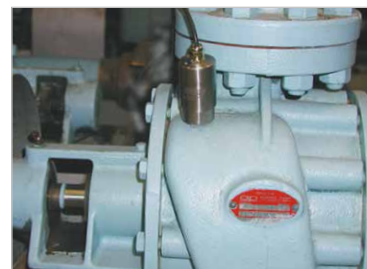
Monitorización de cavitación, rodamientos y válvulas
