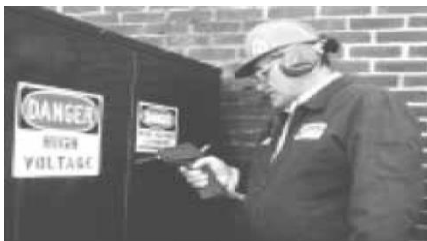
Badaj rozdzielnice, transformatory itd. pod kątem wyładowań niezupełnych, koronowych czy łuku elektrycznego.
